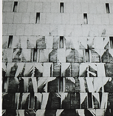
Bijzonder effect van de vervuiling van het travertin van de Bijenkorfgevel. (foto uit: On Weathering)
